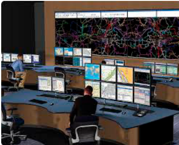
Figura 1.1. Sala de Operación - Centro de Control.
