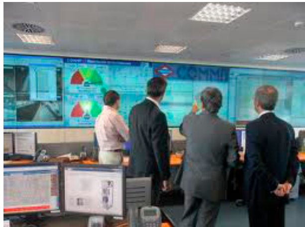
Figura 1.3. Operación - centro de control.
